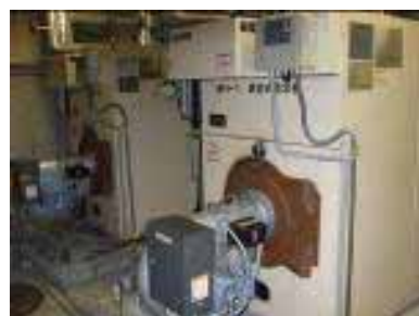
ボイラー設備
