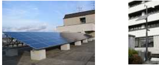
図4 - 5 市本庁舎の太陽光発電設備・ソーラー街路灯
