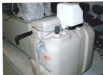
(非常用給水タンク)
