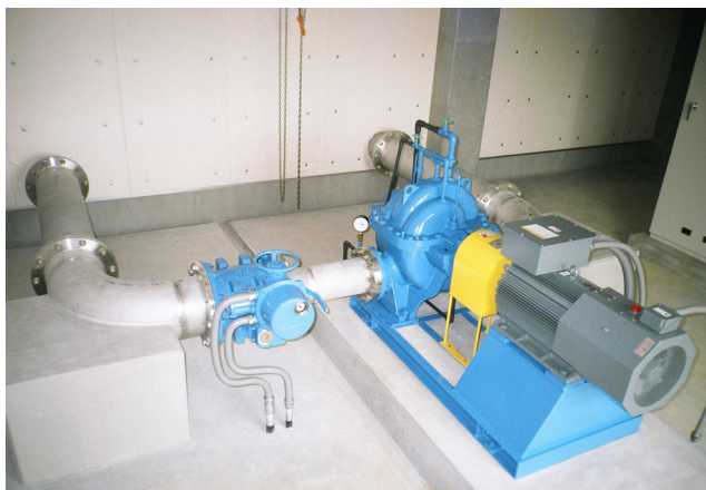
〔小田中浄水場 水力発電設備〕
