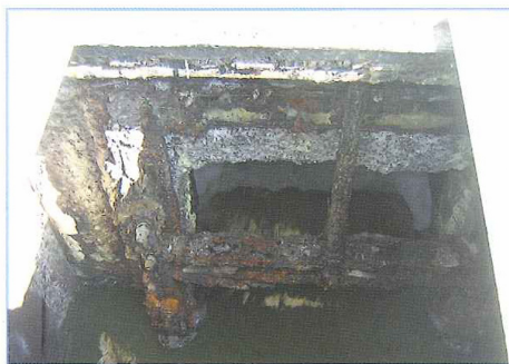
頂版鉄筋露出状況
