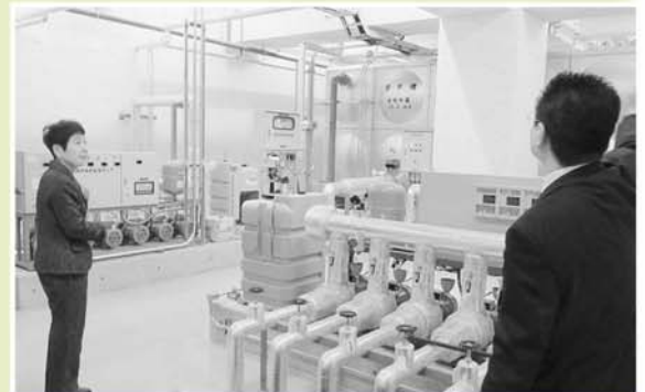
協定締結式後、飯田市の危機管理センターの視察を行いました。(写真は地下貯水タンク施設)
