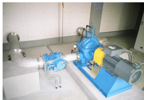
〔小田中浄水場 水力発電設備〕
