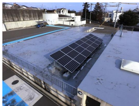
〔小田中浄水場 太陽光パネル〕
