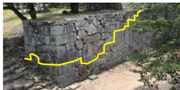
写真3 解体前の裏下門東側石垣(北西から) 修理では黄色の線より上の範囲を解体しました。
