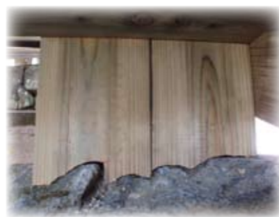
写真5 新しく取り付けられた階段を支える束木の拡大写真。下の雁木の形状に合わせて削っている（光付けという）。
