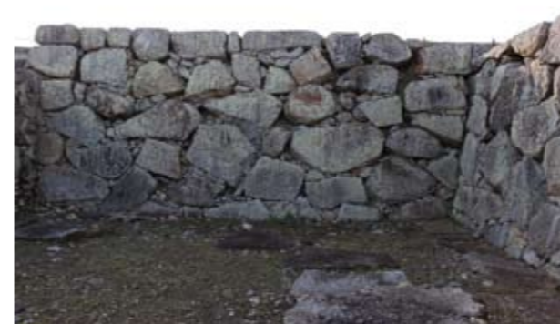
写真9 西面（写真3の2）（補修前）
