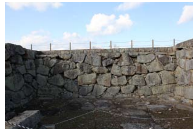
写真11 北面（写真3の3）（補修前）
