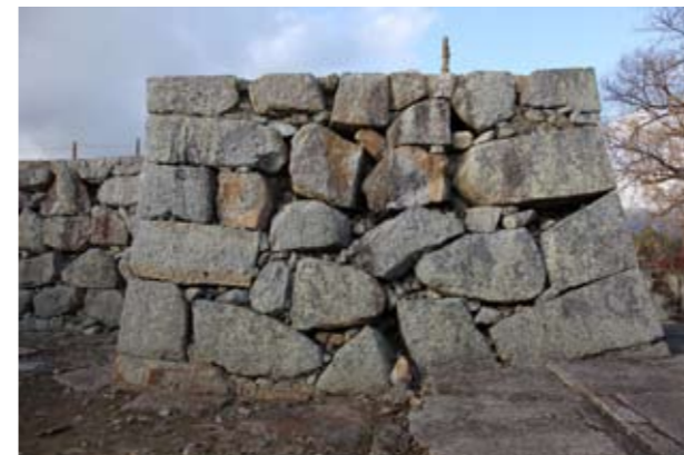
写真13 北面（入口部分）（写真3の4）（補修前）
