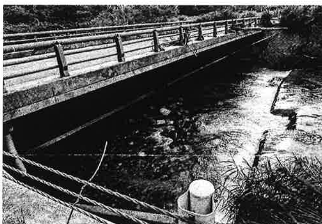
倉見地区：宮の前橋、河川内土砂の堆積による橋の下の断面不足、橋上流部の堤が近すぎるのも一因などの印象をうけた。橋の欄干に流木がかかっている。構造的・抜本的な対策が必要と思われる箇所が多く見られた。
