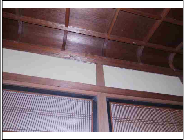
部位：迎賓館内部西側 状況：壁の劣化
