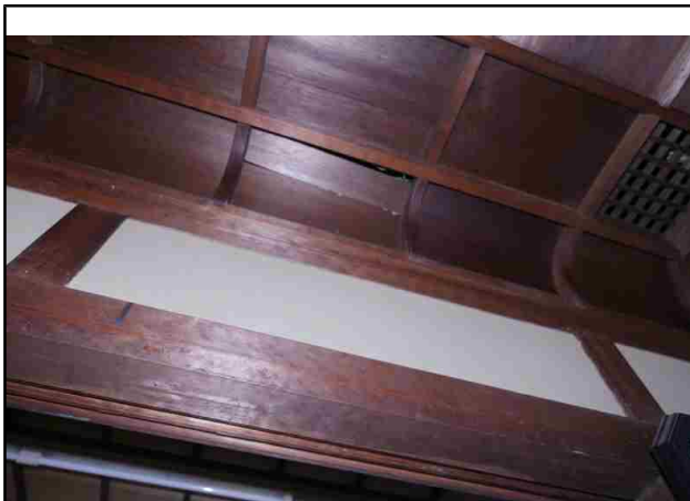
部位：迎賓館内部西側天井 状況：天井板の破損
