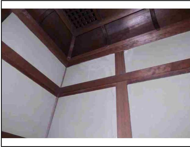
部位：迎賓館内部西側 状況：雨漏れ
