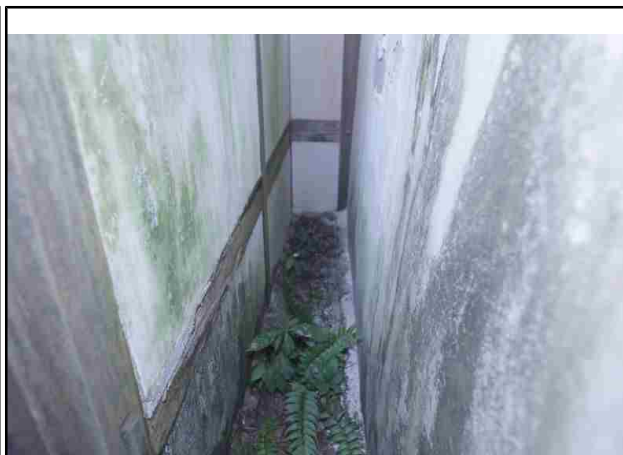
部位：外部西側 状況：土台の劣化
