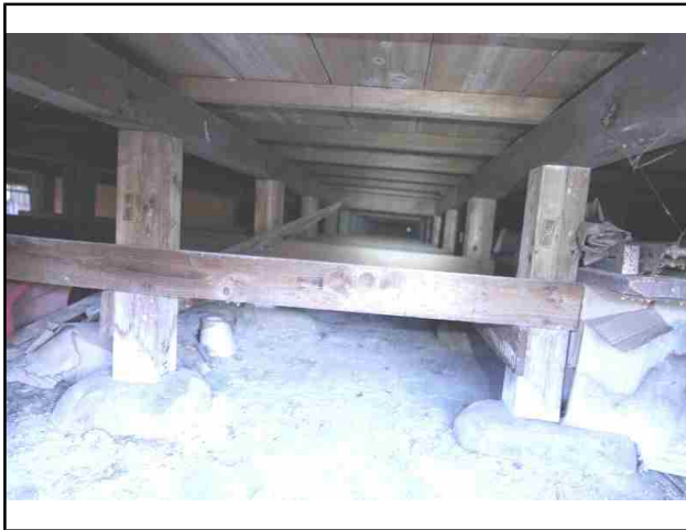
NO.1 床下・和室2下部
