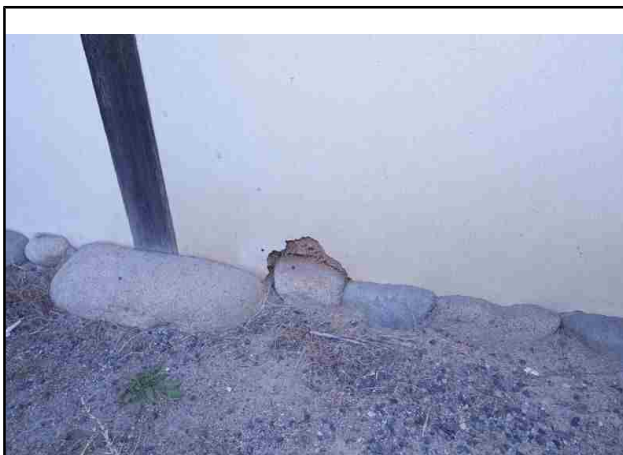
部位：外部東側 状況：外壁の劣化
