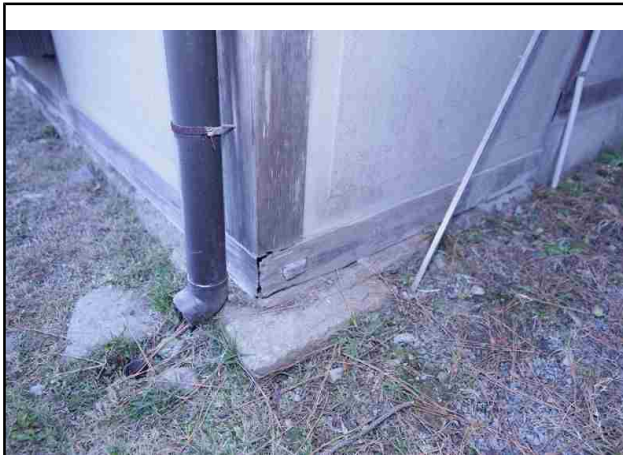
部位：外部北側 状況：土台の劣化
