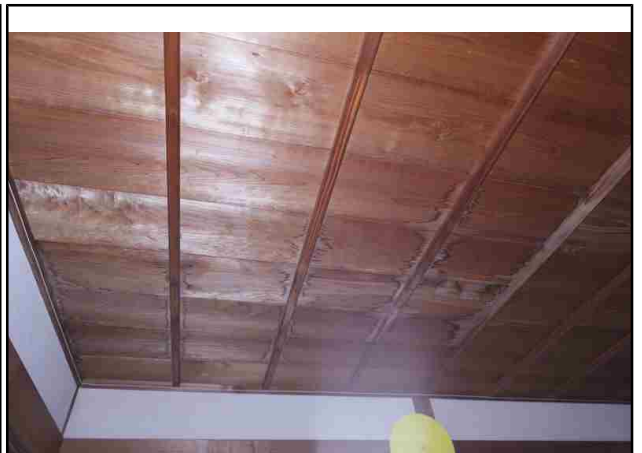
部位：余芳閣2階 和室 状況：雨漏れ
