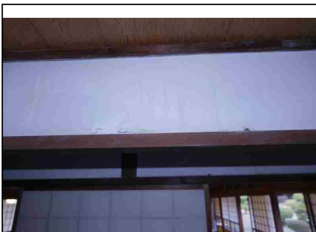
部位：玄関ホール 状況：雨漏れ
