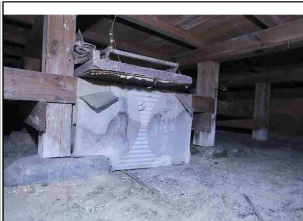
部位：和室2下部 状況：束の浮き
