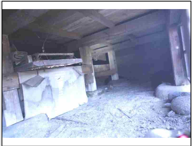
NO.2 床下・和室2下部
