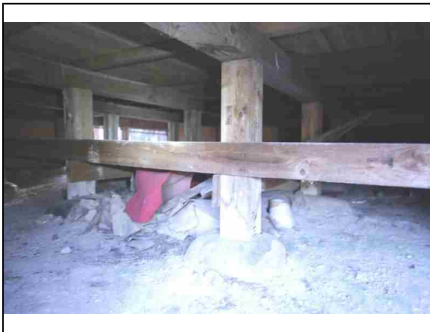
NO.3 床下・和室2下部
