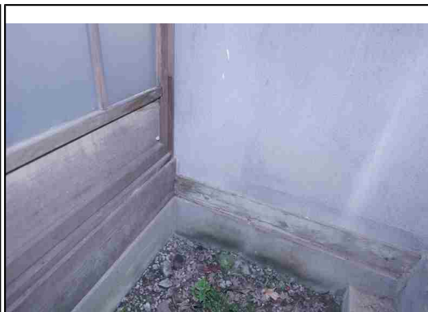
部位：外部西側 状況：土台の劣化
