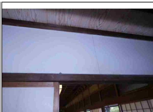
部位：玄関ホール 状況：壁ひび割れ
