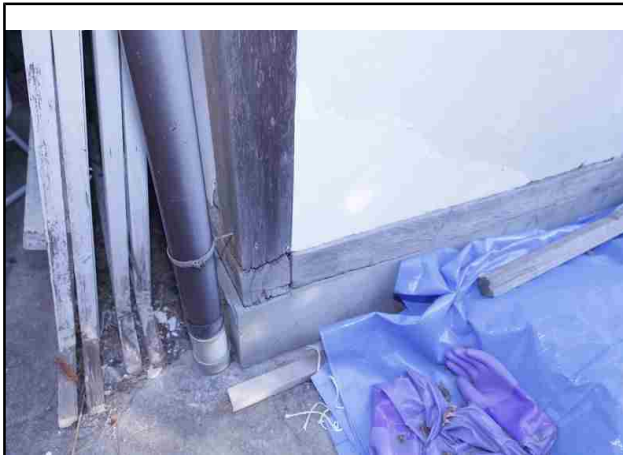
部位：外部西側 状況：柱・土台の劣化
