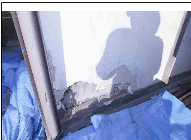
部位：外部西側 状況：外壁の剥がれ
