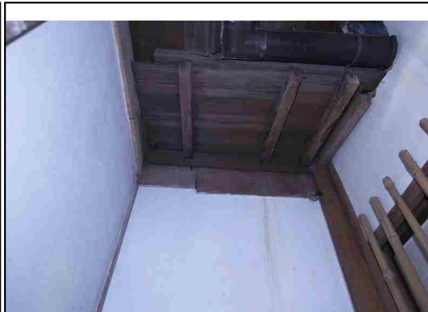
部位：外部西側 状況：外壁雨垂れ
