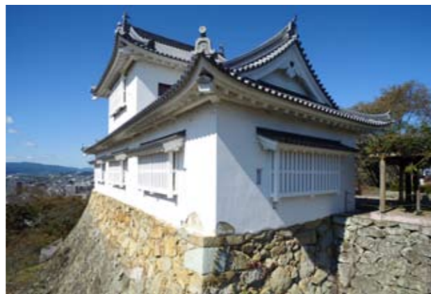
写真9 備中櫓（写真中央が漆喰剥落部分）
