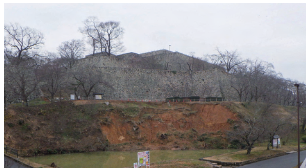
写真9 厩堀法面崩落状況（平成31年1月撮影）（北西から）
