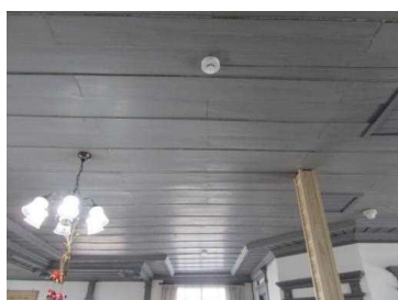
自動火災報知器の設置状況(令和2年度)
