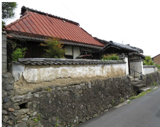
損傷する武家屋敷
