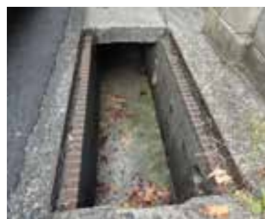
未処理の生活排水が放流されている側溝
