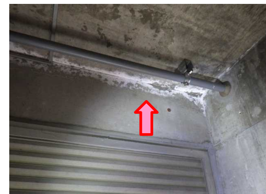
建物内部に発生したエフロ
