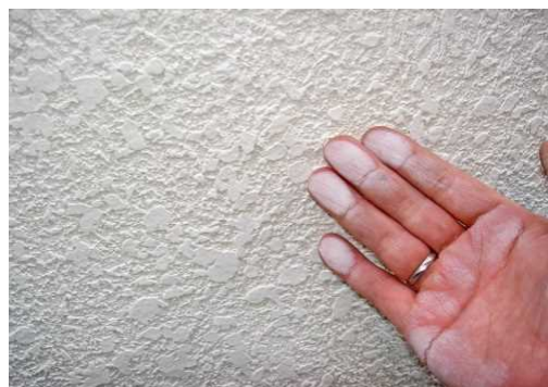
チョーキング現象（塗装劣化のサイン）
