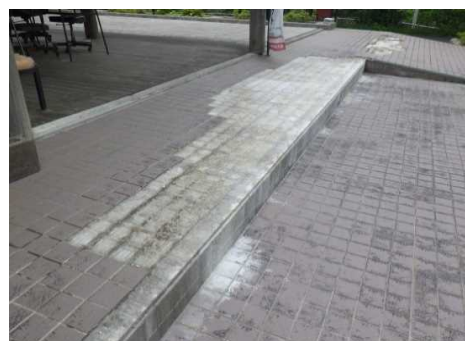
床タイルの脱落は多数散見
