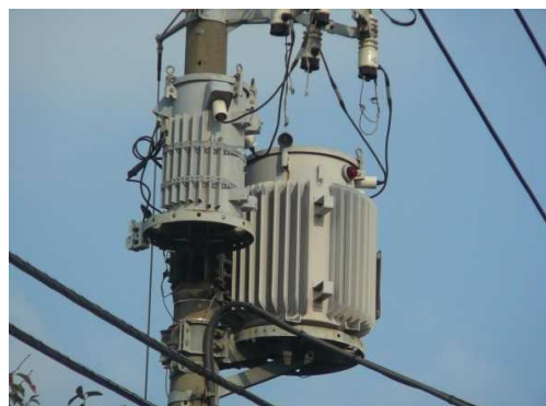
電柱にぶら下がった変圧器
