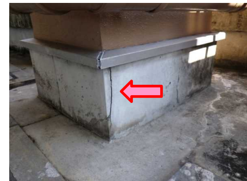
これはコンクリートのひび割れではなくモルタルのひび割れです（少し難問かな）
