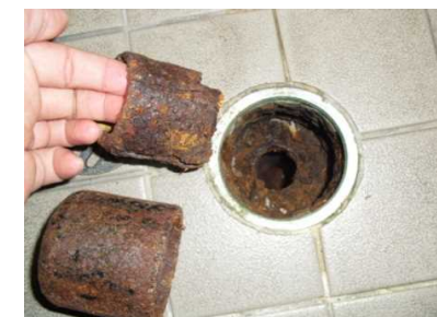
椀トラップの腐食の事例
