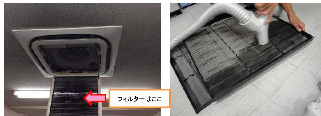
天井カセット型エアコンのフィルターと掃除の様子
