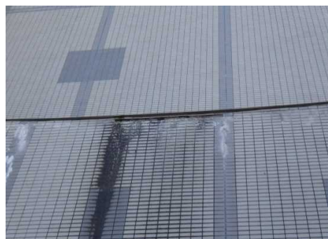
外壁タイルの脱落は非常に危険
