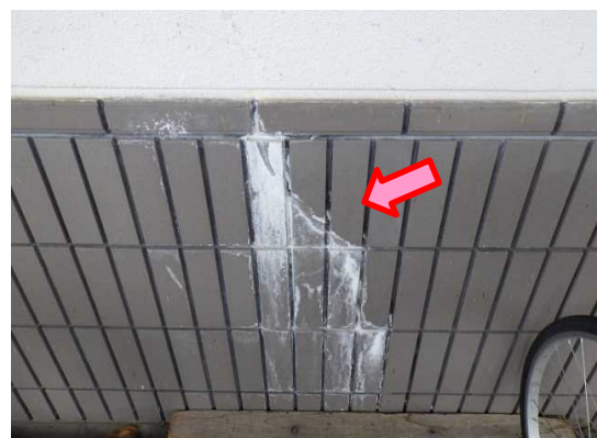
外壁タイルに発生したエフロ
