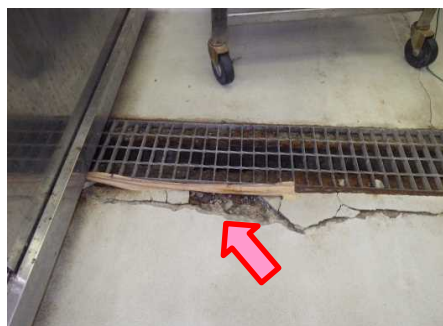
床コンクリートの破損に
