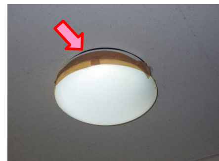
照明器具の脱落に
