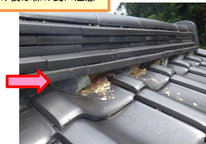
瓦のズレ、漆喰の脱落
