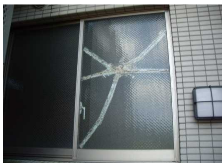
窓ガラスの破損に
