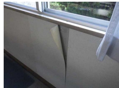
北側の壁に見られるクロスの剥がれ
