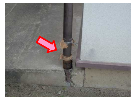
雨樋の破損に
