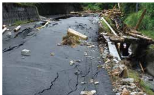
豪雨によって舗装が崩壊した加茂町物見地内の市道古屋線
