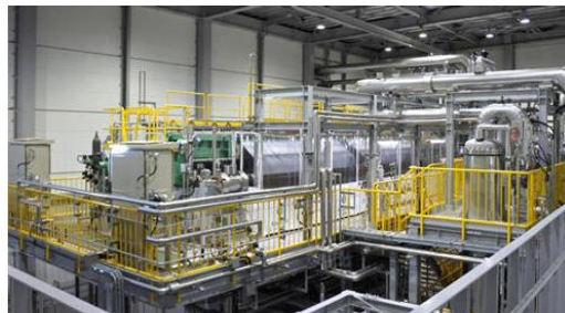
10MWの水電解装置
